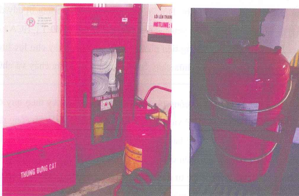
Hình 3.20. Một số hình ảnh thiết bị PCCC của cơ sở
