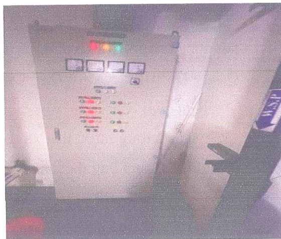
Hình 1.9. Tủ điện phòng cấp nước tổng của khu chung cư
